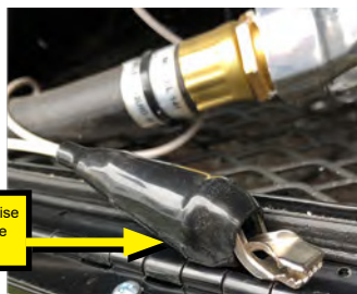
Clip de mise à la terre à l'intérieur de la station de carburant
